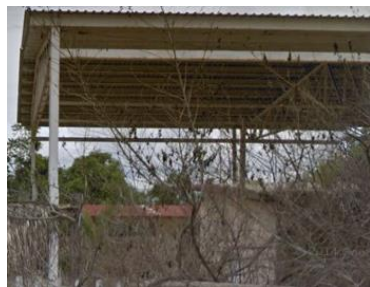
OXIDACIÓN DE ELEMENTOS METÁLICOS
