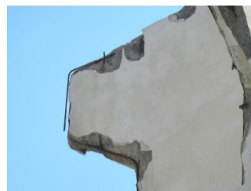
DAÑO EN ELEMENTOS DE CONCRETO
