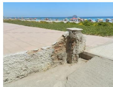
DAÑO POR EROSIÓN
